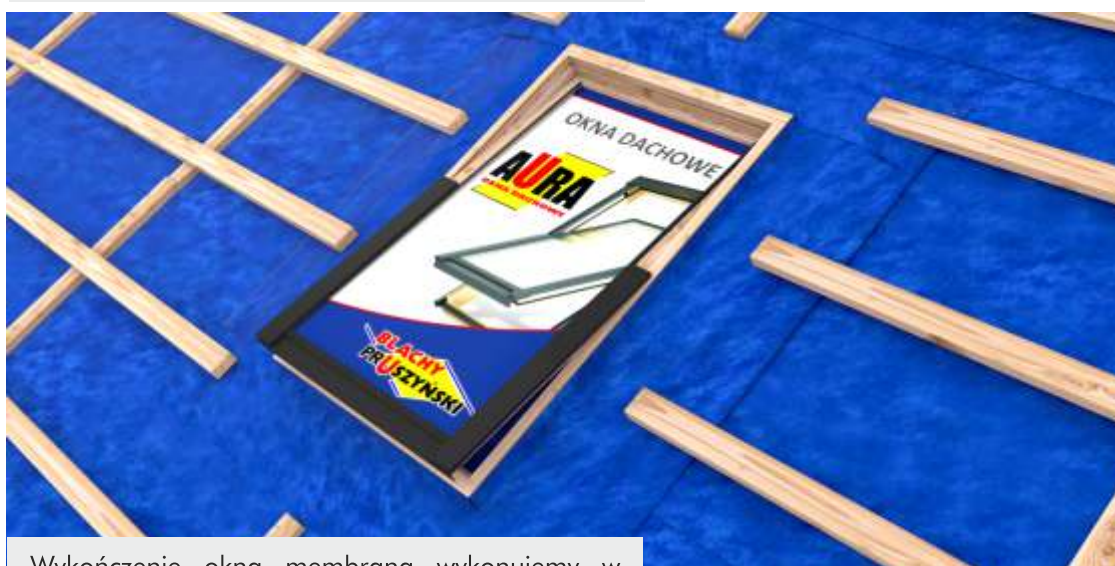
Wykończenie okna membranę wykonujemy w sposób standardowy pamiętając o konieczności zachowania szczelności połączeń
